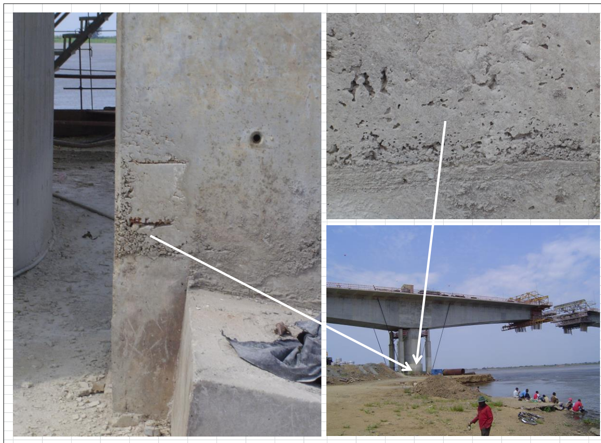
Figura 8.4: Erros na compactação/vibração do betão nos pilares da ponte sobre o Rio Zambeze (Caia-Chimuara).
