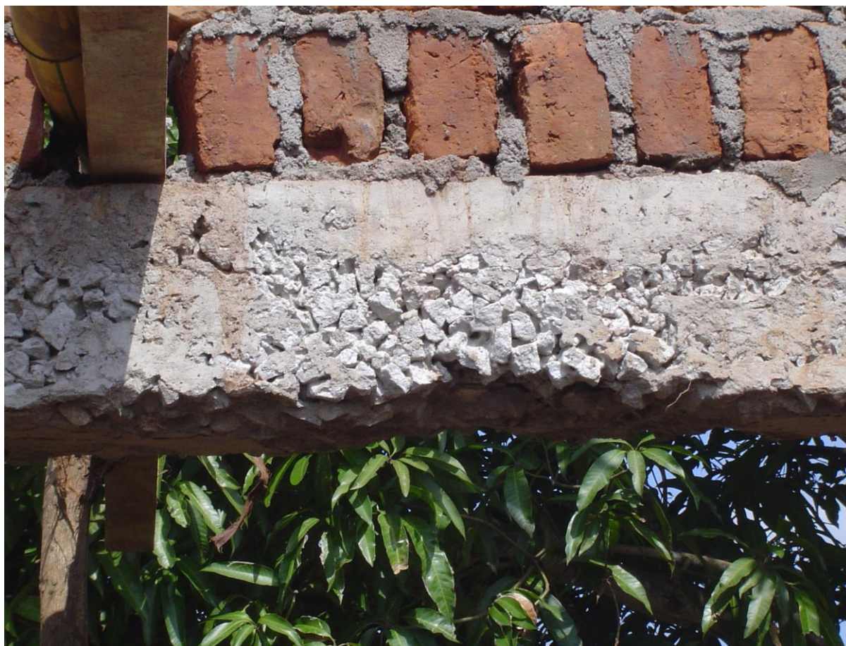
Figura 8.3: “Ninho de pedras”, um erro na compactação do betão e na colocação da cofragem.
