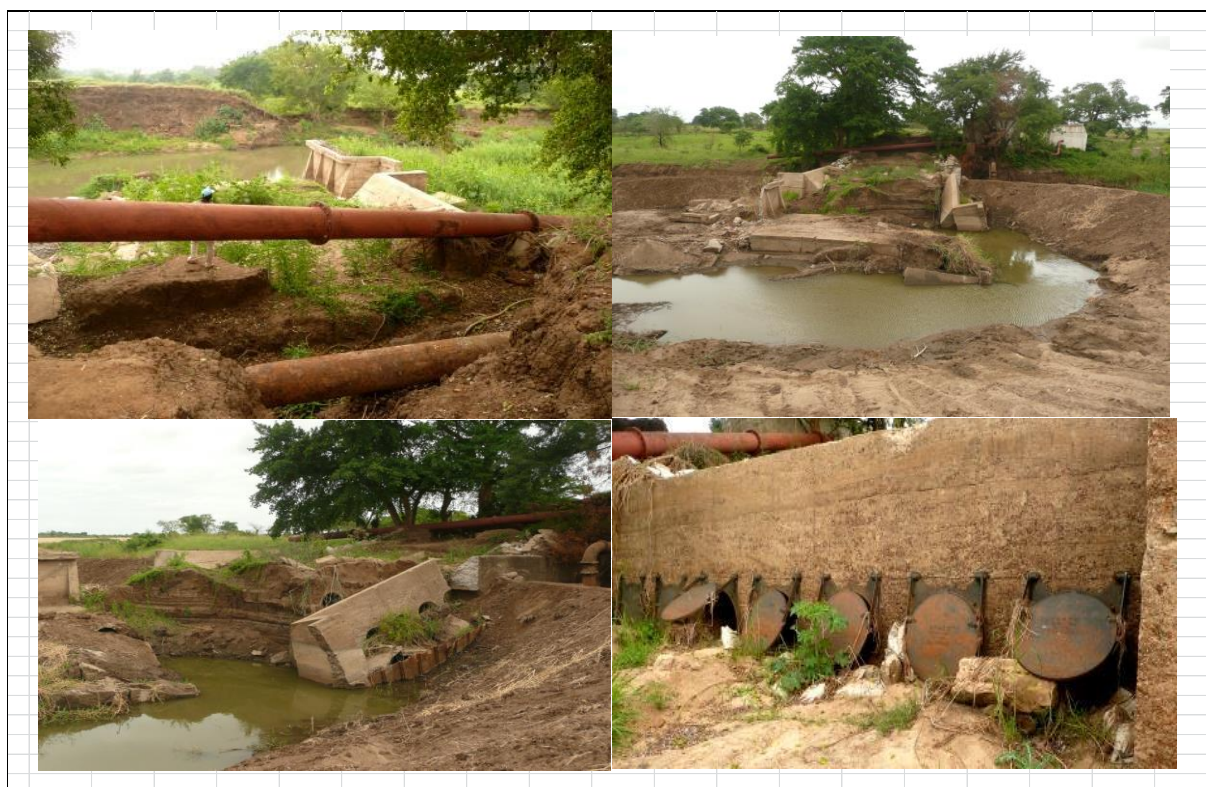
Figura 3.10: Danificações na saída da vala 1.
