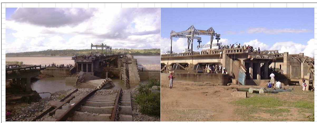
Figura 3.8: Danificações na estrada e linha férrea na barragem de Macaretana.
