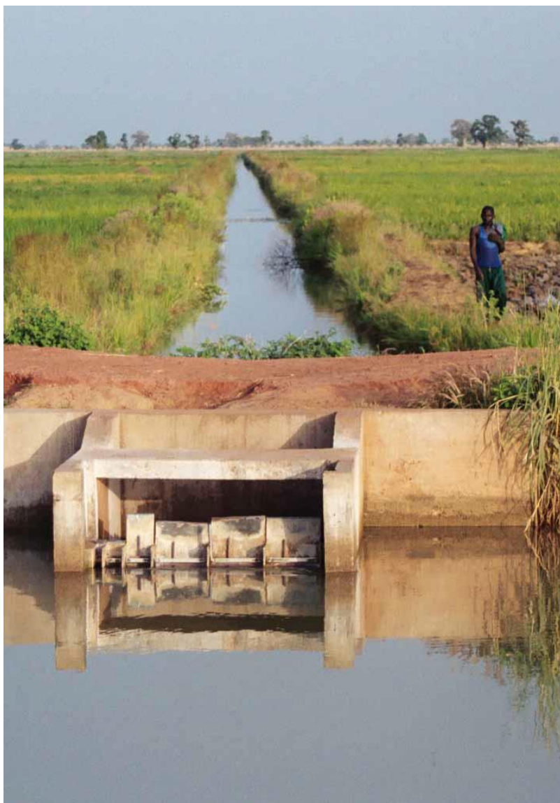
Figura 7.12: Comporta Neyrpic no início do canal terciário no Office du Niger (copiado da lit 163).
