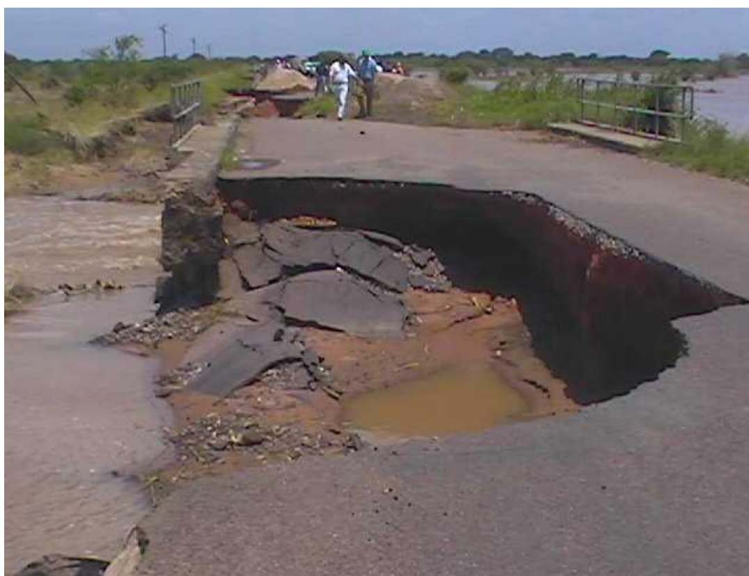
Figura 3.18: Ponte danificada na secção do N1 onde esta atravessa a planície do Incomati.
